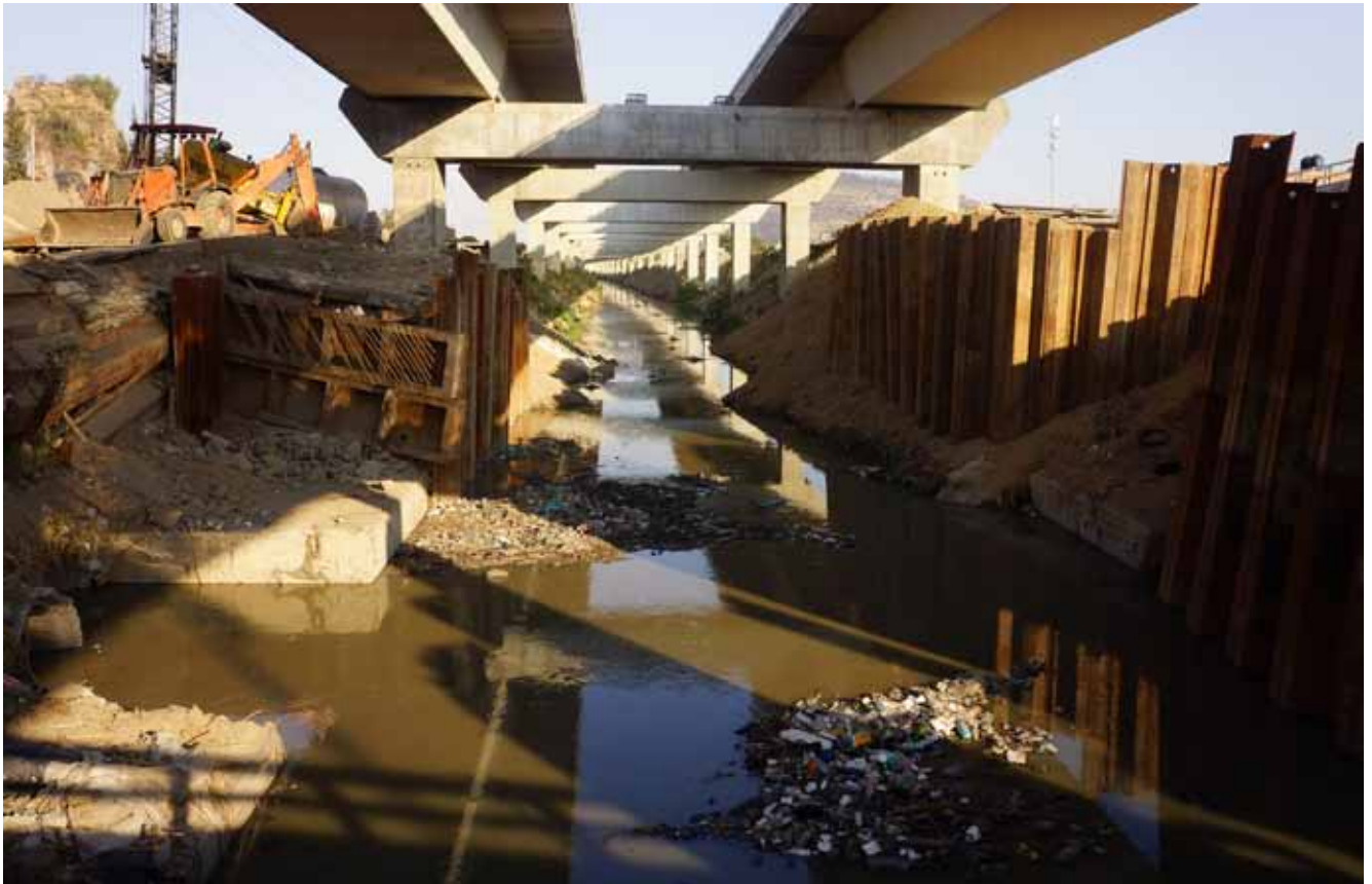
Figura 17. Vista del río de los Remedios, cuyo cauce funge actualmente como canal de aguas residuales. Foto: Jenifer Segura 2013.
